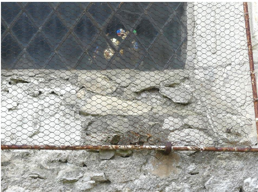
Façade nord, baie 5, cadre métallique corrodé et maille de médiocre qualité déformée
