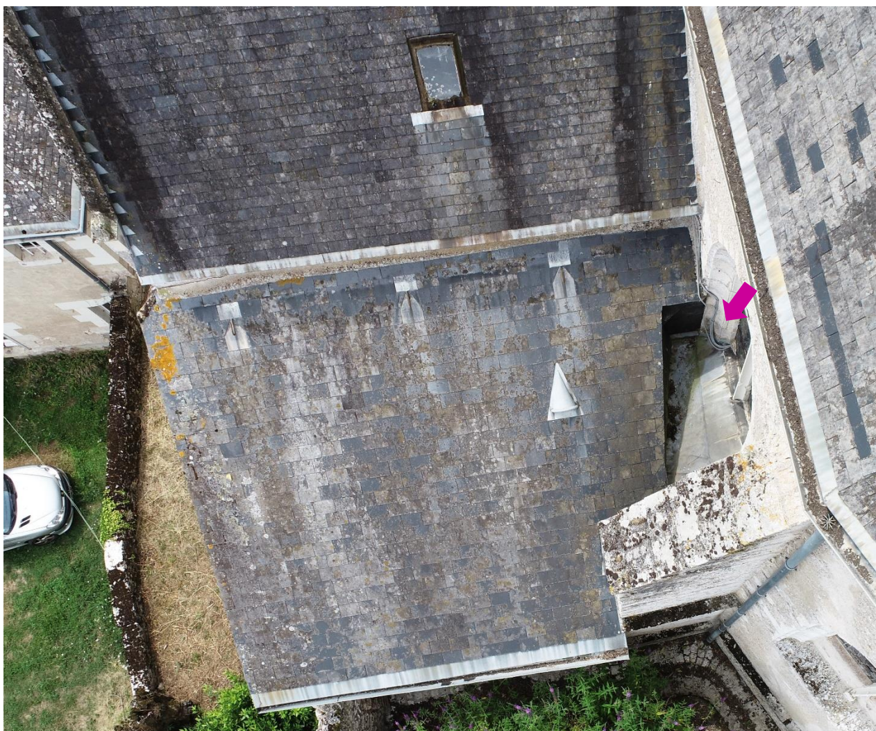
Toiture de la sacristie, chéneau encaissé recevant les eaux de pluie du versant est de la chapelle Sainte-Radegonde et de la sacristie (quantité importante), ouvrage défaillant au regard des importantes infiltrations constatées sur l'intrados de la voûte de la sacristie. Gouttières encombrées de déchets végétaux
