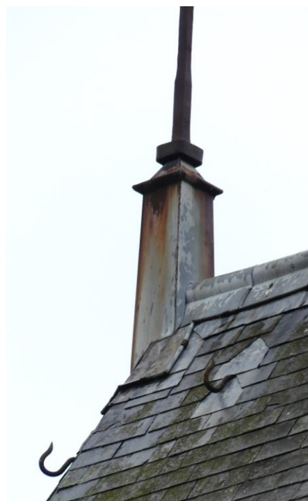
Base de la croix du chevet corrodée (importantes infiltrations constatées sur la charpente au niveau du poinçon sous-jacent)
