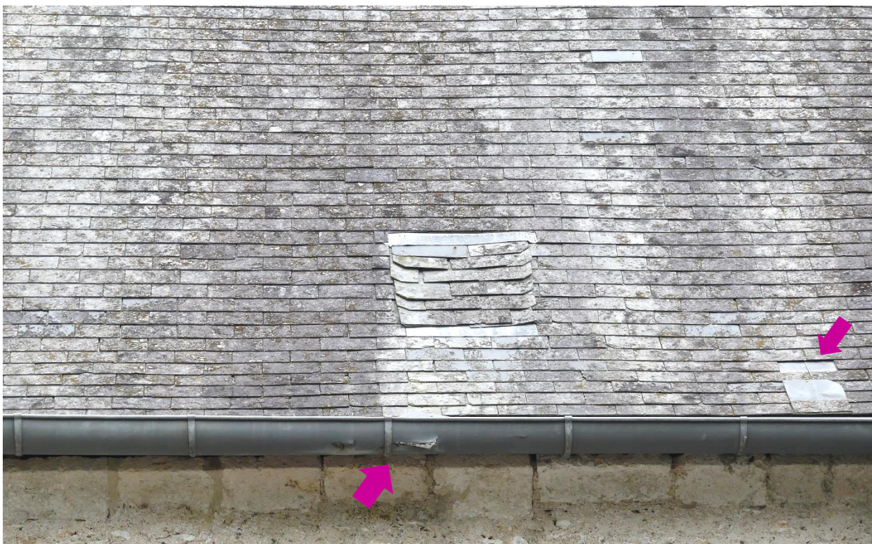
Versant nord-est du chevet, glissements d'ardoise, gouttière perforée suite à la chute d'une ardoise, quelques repiquages, trappe vétuste
