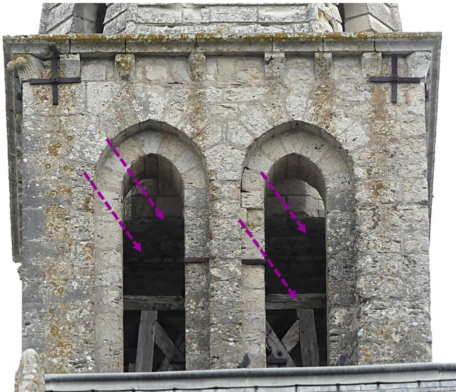
Baies sud du clocher sans protection exposant le beffroi aux intempéries
