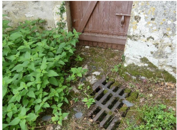
Venelle sud, grille avaloir à l'extrémité ouest du fil d'eau partiellement encombrée de déchets terreux et de végétaux
