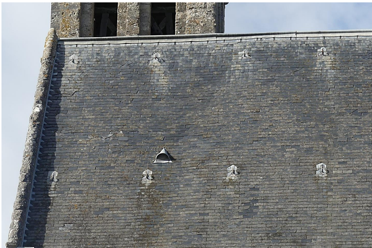
Versant sud de la nef, glissements d'ardoise, importante désorganisation de la couverture
