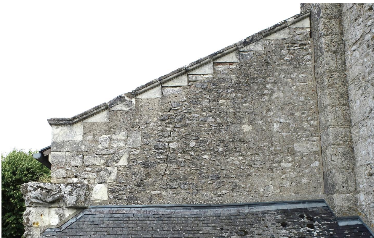
Pignon du bas-côté nord, fissure de compression
