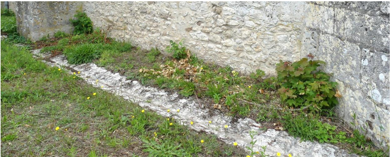
Ci-dessous : Façade sud, développement de végétation en pied de mur
