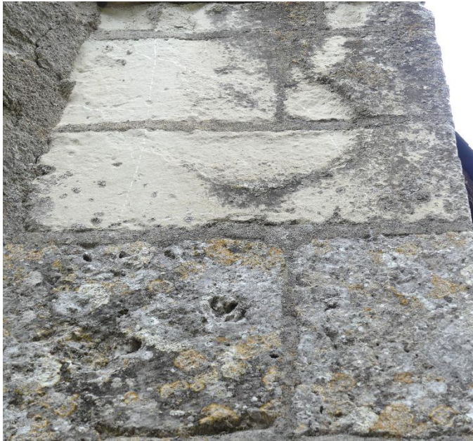
Contrefort en façade nord pollué par des lichen gris
