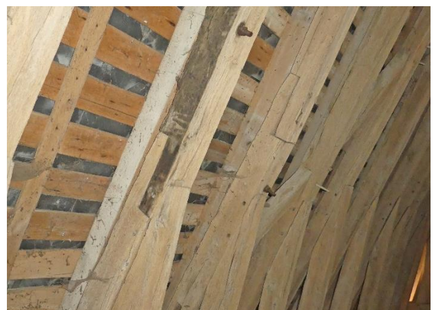
Chœur, importantes fourrures sur le chevrons, réparation par enture
