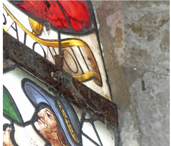
Baie 6 (façade sud), feuillard et clavette corrodés en surface
