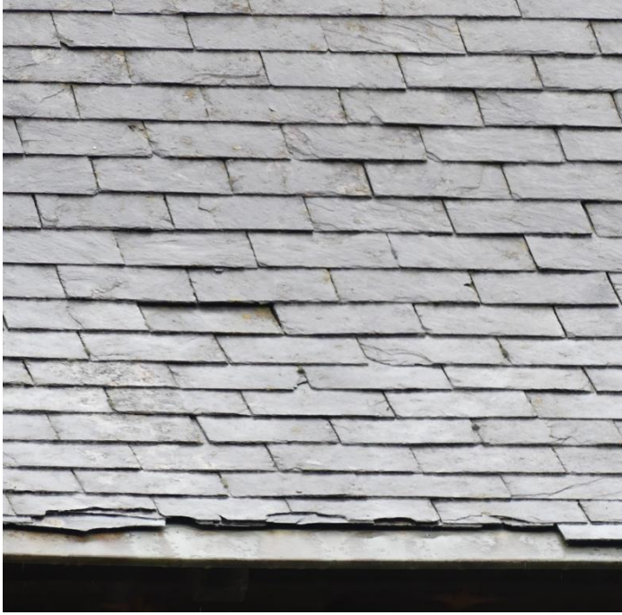
Couverture du versant nord de la nef : casse, glissement et lacune d'ardoise
