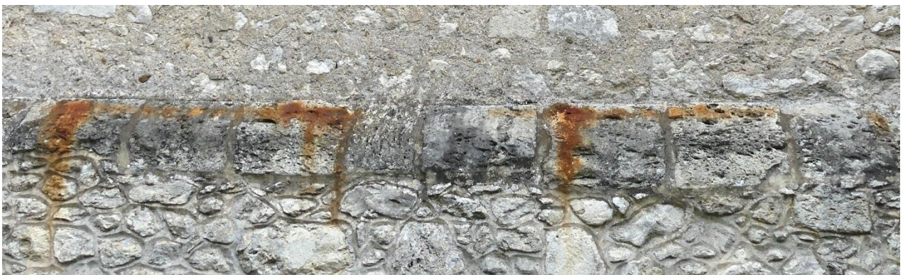
Façade sud, pierres de taille tâchées par l'oxyde de fer provenant des protections grillagées corrodées
