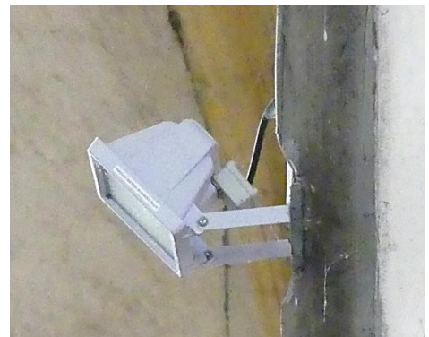
Eclairage de la nef sommaire et dépareillé, passage de câble peu esthétique
