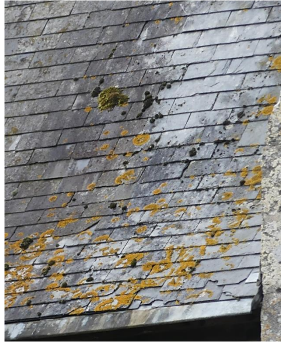
Couverture du versant nord de la nef : casse et glissement d'ardoise. Pollution microbienne par des lichens jaunes et développement de mousse
