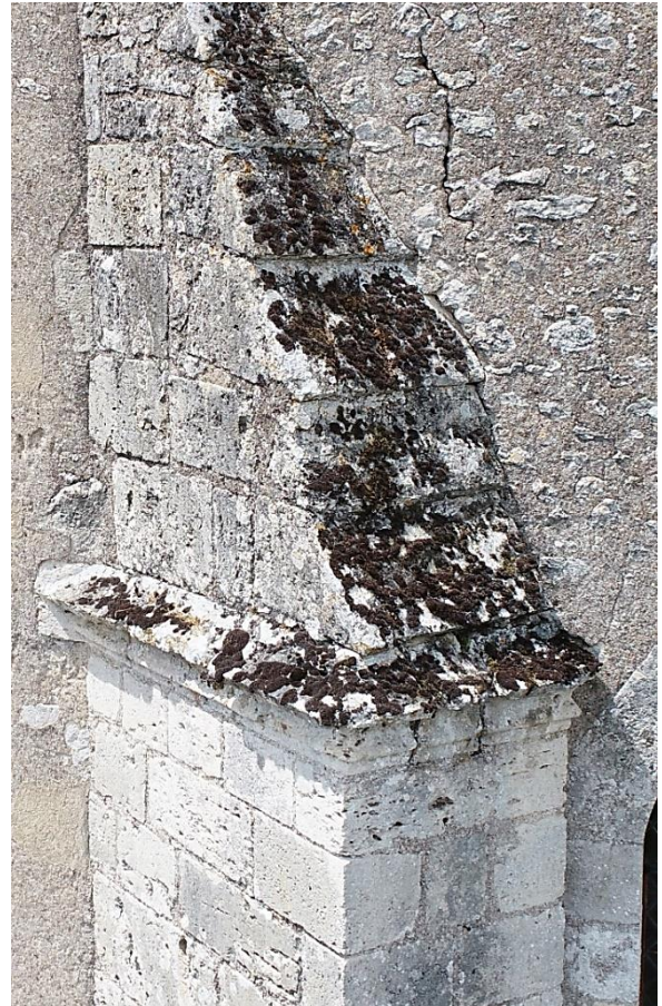
Façade sud, tête de contrefort d'angle, pollution microbiologique, le larmier joue bien son rôle puisque le corps du contrefort n'est, en revanche, pas pollué
