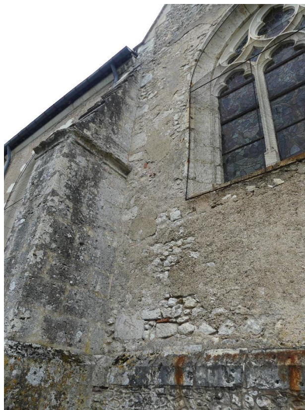
Façade sud, maçonnerie déjointoyée localement et reprises ponctuelles au mortier hydraulique
