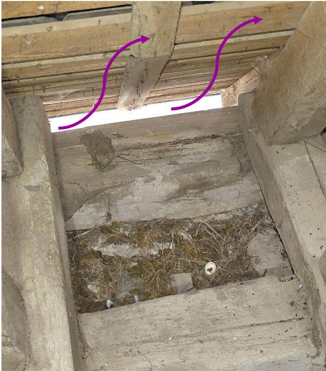
Ouverture entre l'arase du mur gouttereau de la nef et le bas de pente de la toiture permettant aux volatiles de pénétrer dans le comble. Présence de nid sur les arases entre les pannes sablières
