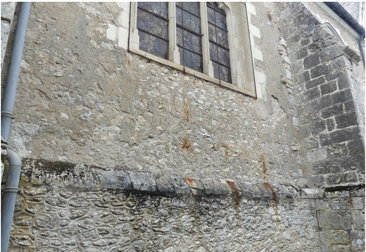
Façade sud, enduit de finition lacunaire avec décrochement par plaques, tâches d'oxyde de fer provenant de la protection du vitrail corrodés
