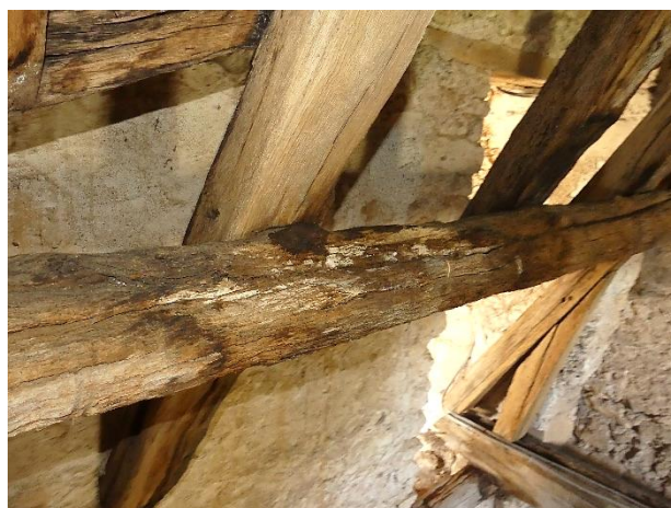
Chapelle Sainte-Radegonde (sud), panne, pourriture cubique
