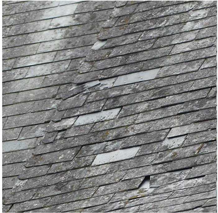
Couverture du versant nord de la nef, rive désorganisée et repiquage d'ardoise au clou non réalisé dans les règles de l'art (clous exposés aux intempéries accélérant ainsi leur altération)
