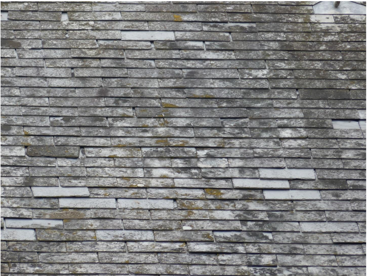
Couverture du bas-côté nord présentant de nombreux repiquages d'ardoise au clou et au crochet
