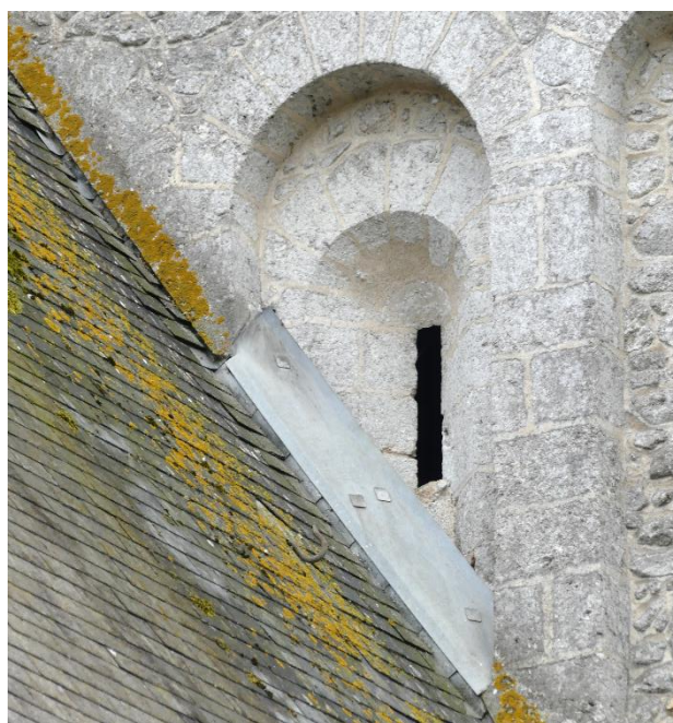
Versant nord de la nef, étanchéité de rive provisoire (infiltrations observées dans le comble au droit de cette zone)
