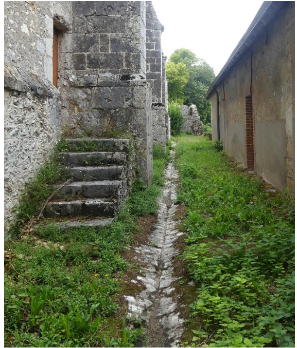
Venelle sud, fil d'eau pavé déjointoyé, développement de végétation de part et d'autre limitée
