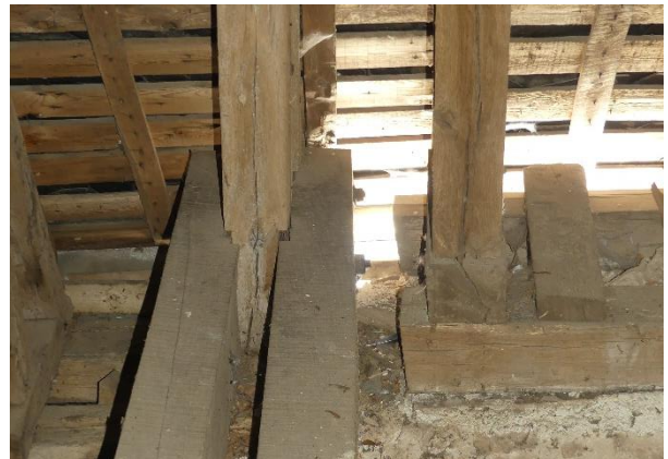
Rupture de la continuité des pannes sablières à la jonction entre la nef et le chœur
