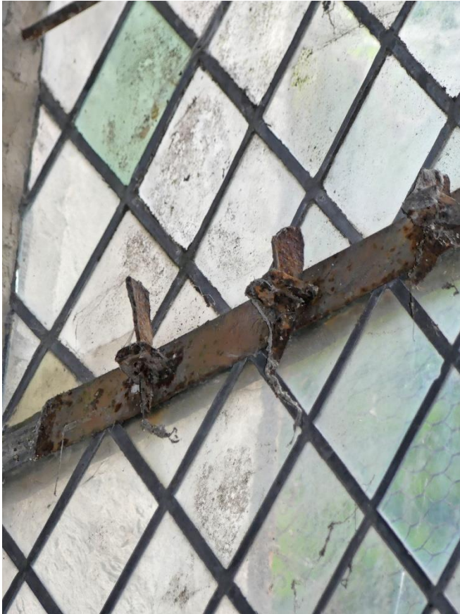
Baie 7 (façade nord), feuillard et clavettes corrodés en surface et verres encrassés (poussière et pollution microbologique)
