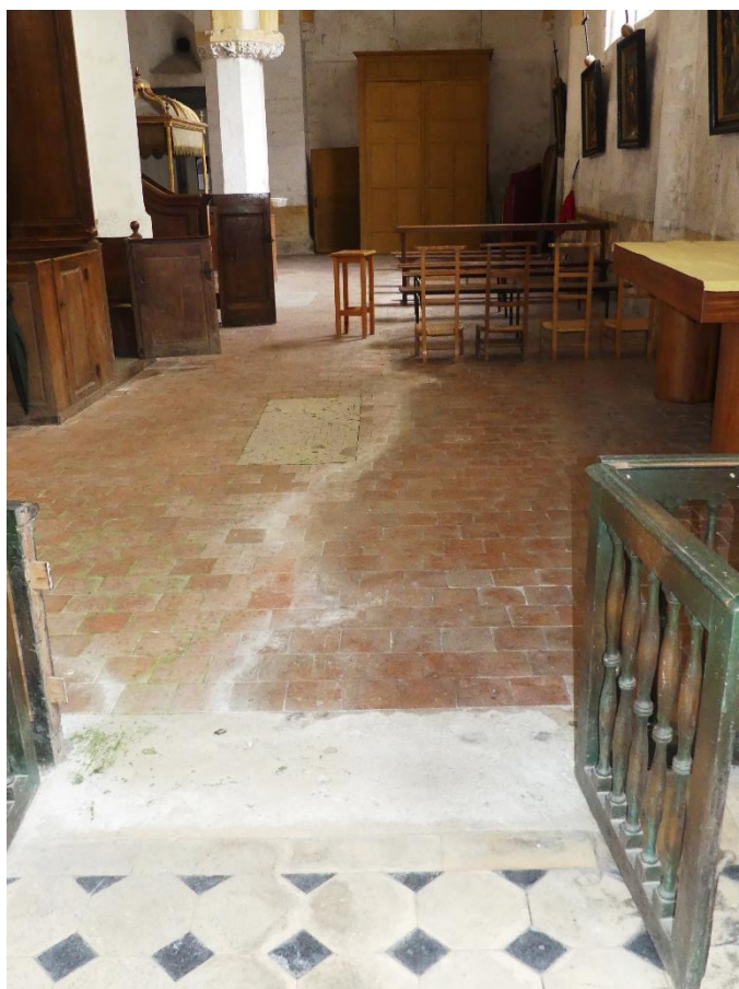
Bas-côté nord, efflorescences salines sur les tommettes du sol indiquant la présence d'humidité
