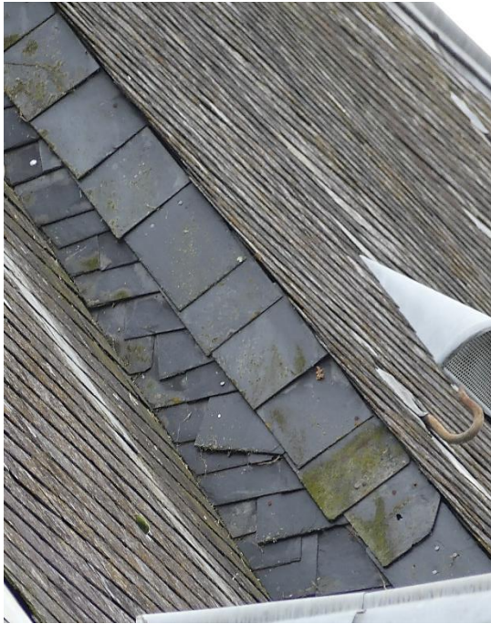
Rive du versant nord de la nef désorganisée, lacune d'ardoise, clous oxydés
