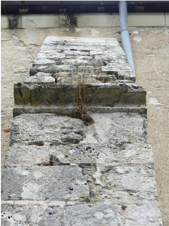
Façade sud, glacis de contrefort lessivé par les eaux pluviales, joints lacunaires et parement fragilisé
