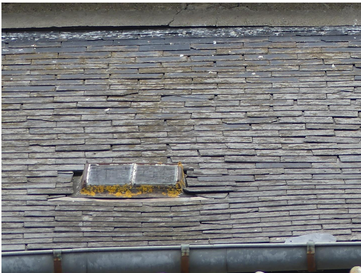
Bas-côté sud, affaissement et désorganisation de la couverture, glissements et lacunes d'ardoise, étanchéité du châssis de toit non garantie
