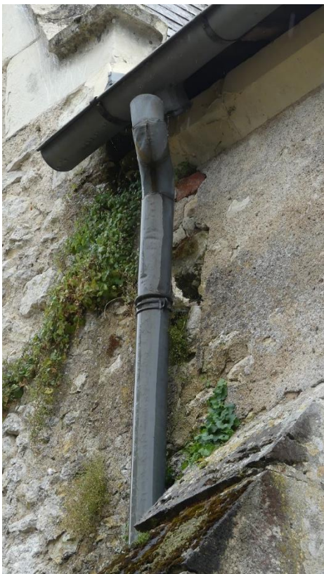
Jonction entre le bas-côté nord et la chapelle nord, défaut de raccordement entre la gouttière et la DEP entraînant un écoulement des eaux pluviales sur le parement pierre et sa dégradation et le développement de végétaux
