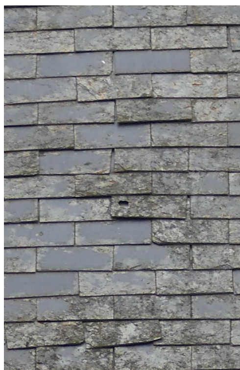
Versant sud de la nef, ardoise percée (probable impact de grêle)
