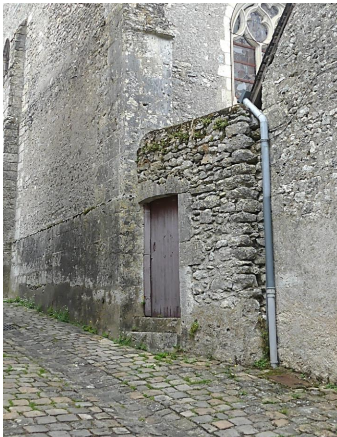
Façade ouest, muret clôturant la venelle sud complètement déjointoyé
