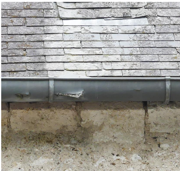
Versant nord-est du chevet, glissements d'ardoise, gouttière perforée suite à la chute d'une ardoise
