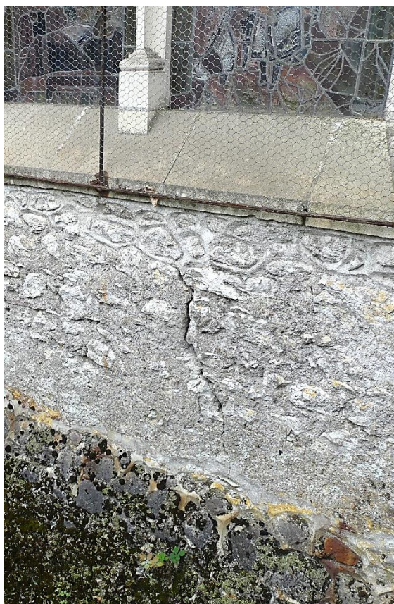
Façade nord, fissure de compression sous la baie
