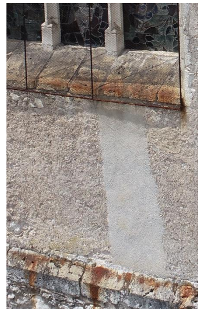
Façade sud, pierres de taille tâchées par l'oxyde de fer provenant des protections grillagées corrodées
