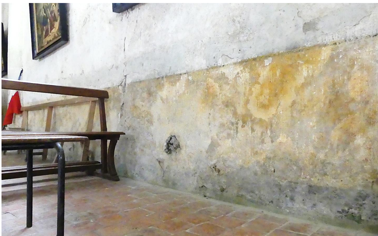
Mur nord de la nef, développement d'algues vertes et déplaquage d'enduit localisé
