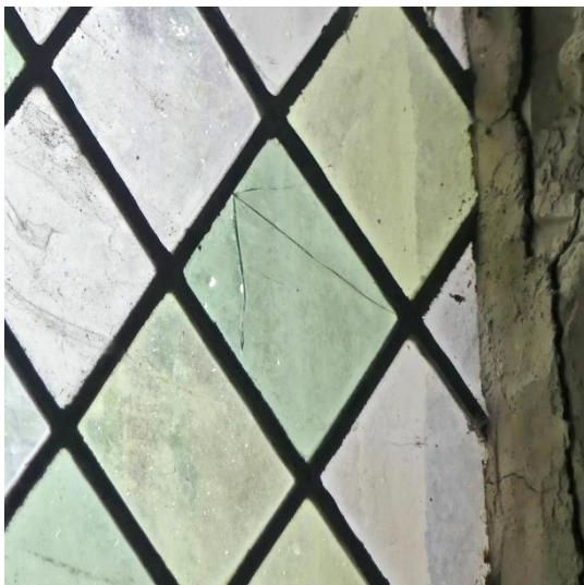
Baie 7 (façade nord), verre fracturé
