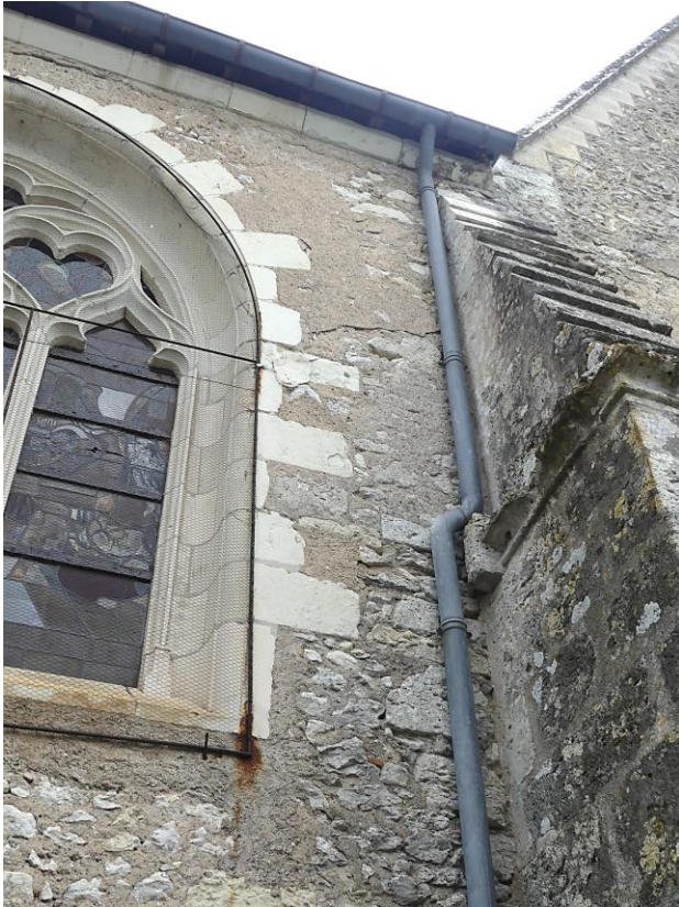
Façade sud, déplaçage d'enduit de finition et maçonnerie déjointoyée au droit de la DEP probablement fuyarde
