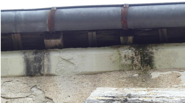
Façade sud du bas-côté, corniche desquamée et développement d'algues vertes suite à un défaut d'étanchéité de la couverture ou de la gouttière
