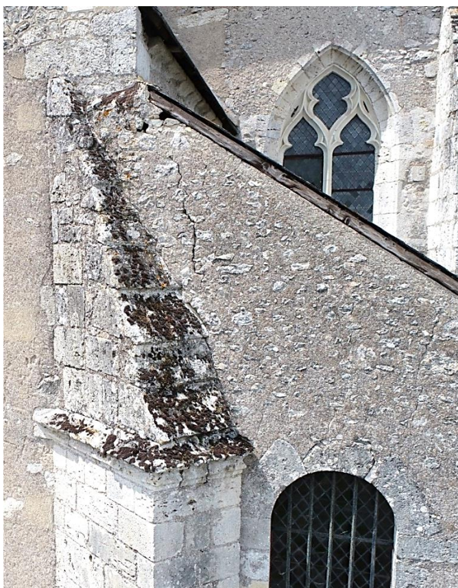
Façade sud de la sacristie, fissure de construction au droit du contrefort d'angle de la chapelle sud
