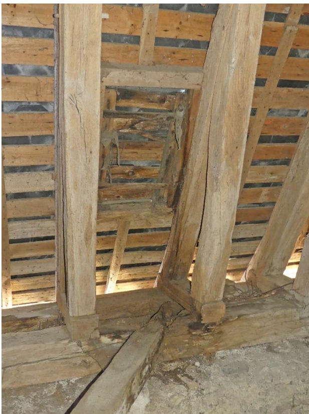
Chœur, infiltration au droit d'une trappe ayant altéré les bois sous-jacent : importante perte de matière de la panne sablière intérieure et du lien avec l'entrait
