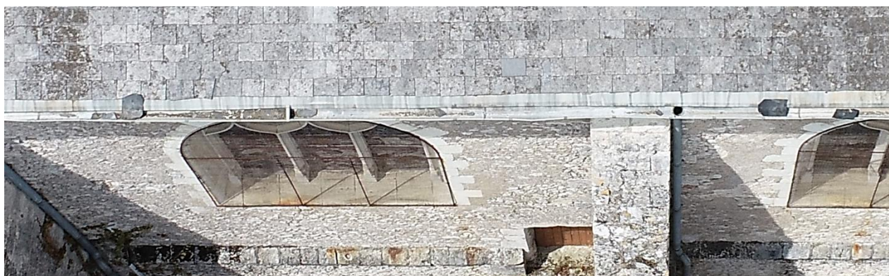
Bas-côté sud, ardoises décrochées se trouvant dans la gouttière
