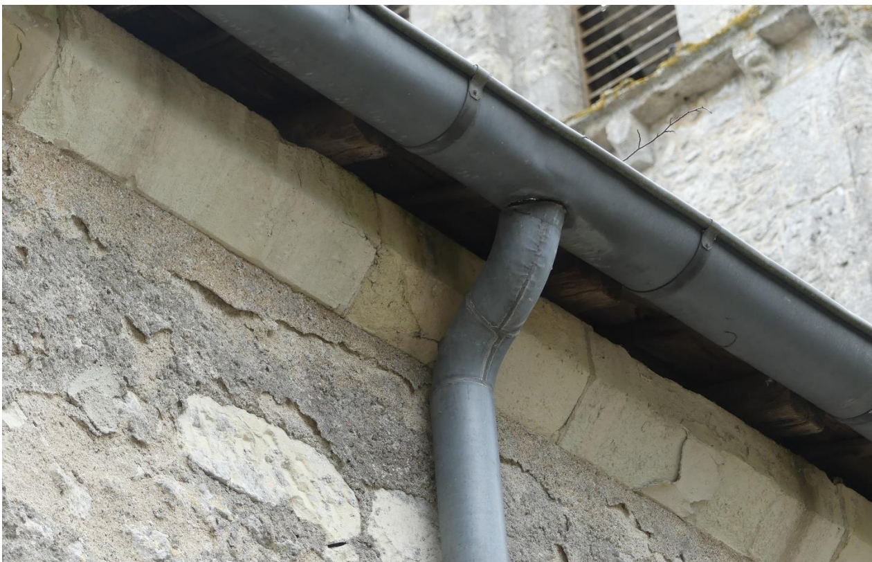
Bas-côté nord, défaillance de l'étanchéité en bas de pente (doublis zinc) et du raccord de la gouttière à la DEP entraînant des infiltrations et des altérations de la corniche en pierre sous-jacente
