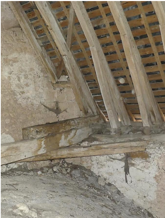
Infiltration au droit du clocher sans altération conséquente des bois
