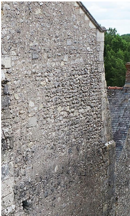
Façade ouest de la nef, maçonnerie déjointoyée localement
