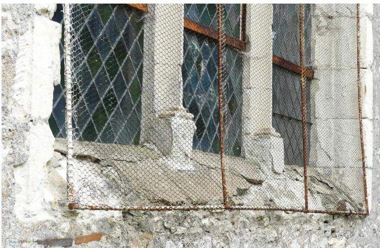
Façade nord, baie 7, appui de baie ruiné et pieds de meneau desquamés
