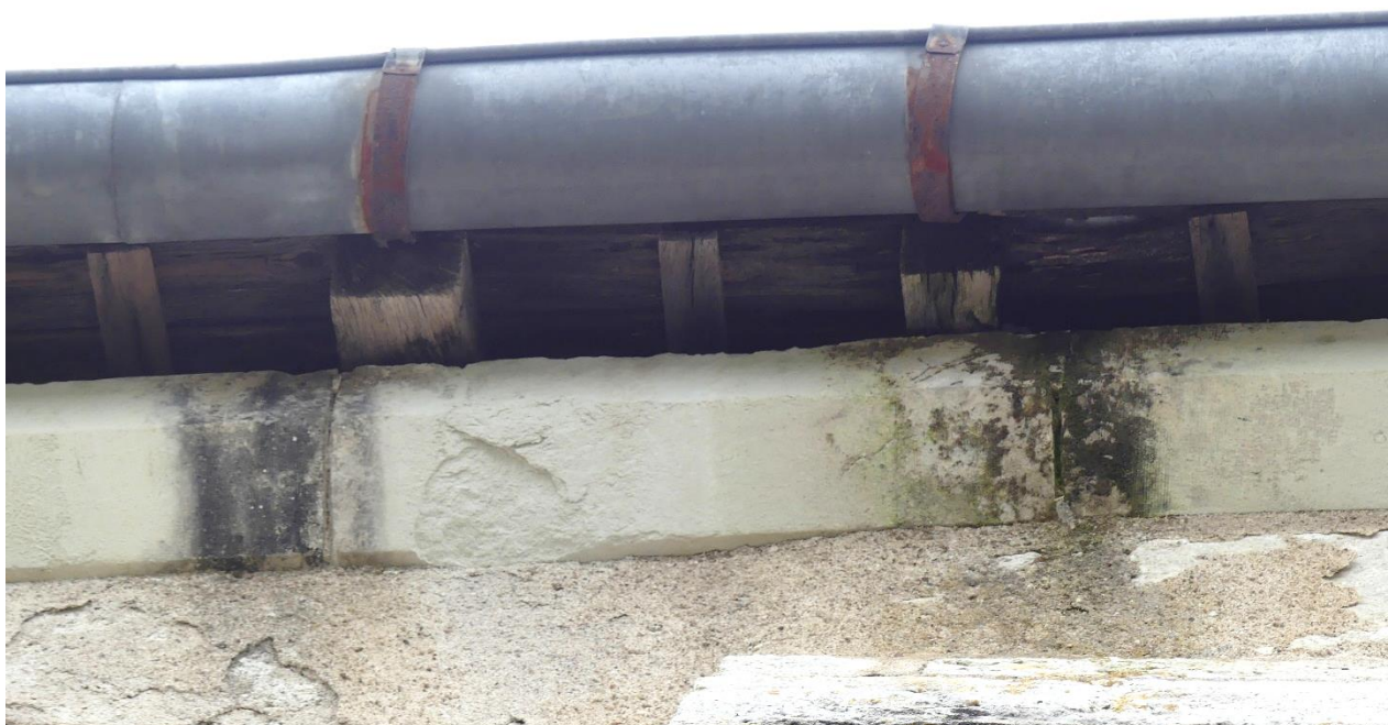
Bas-côté sud, défaillance de l'étanchéité en bas de pente entraînant des infiltrations et des altérations de la corniche en pierre sous-jacente (développement d'organismes microbiologiques et desquamation)
