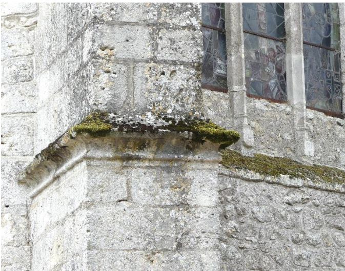
Façade est, bandeau saillant du contrefort et glacis recouvert de mousse et de lichen
