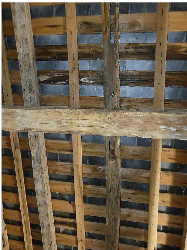
Bas-côté sud, chevrons de réemploi dégradés par l'humidité
