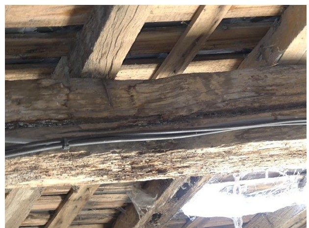
Bas-côté sud, panne altérée à cause des infiltrations
