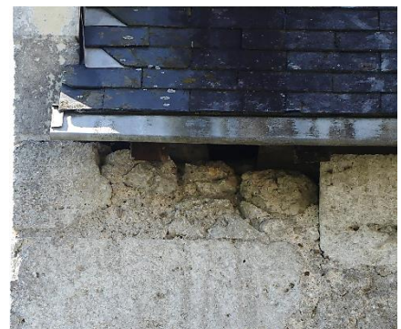
Façade est de la chapelle sud, corniche remplacée par des moellons désorganisés
