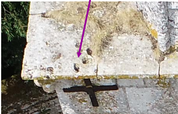
Angle sud-ouest, trous dans la corniche
