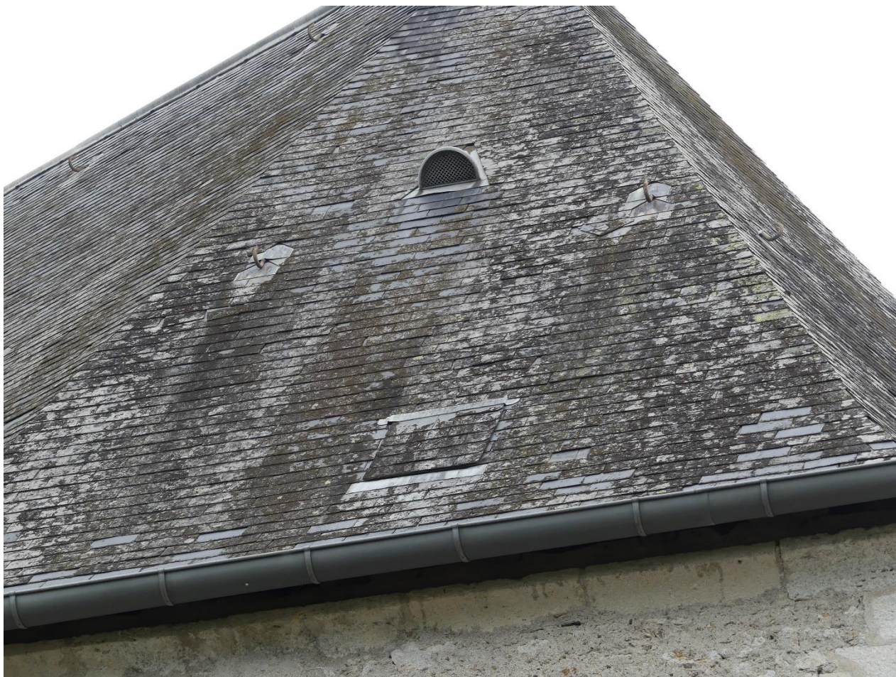
Versant sud-est du chevet, nombreux repiquages, glissements et lacunes d'ardoise
