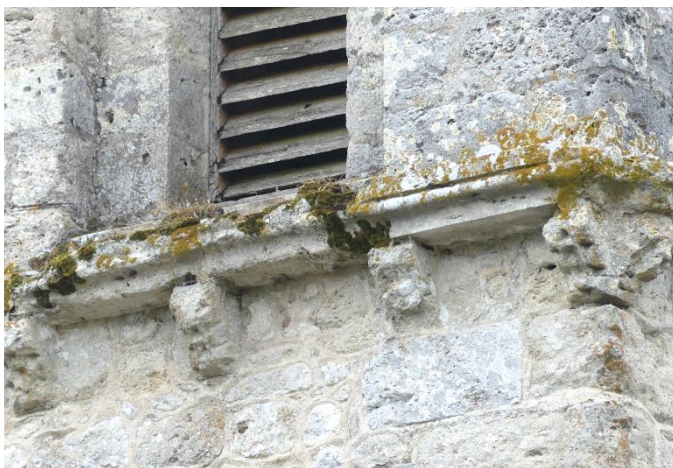
Façade nord du fût du clocher, développement de lichens jaunes
