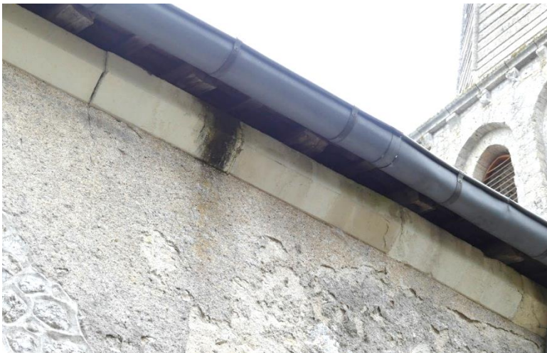
Façade nord du bas-côté, corniche desquamée en plusieurs points suite à un défaut d'étanchéité de la couverture et du dispositif d'évacuation des eaux pluviales
