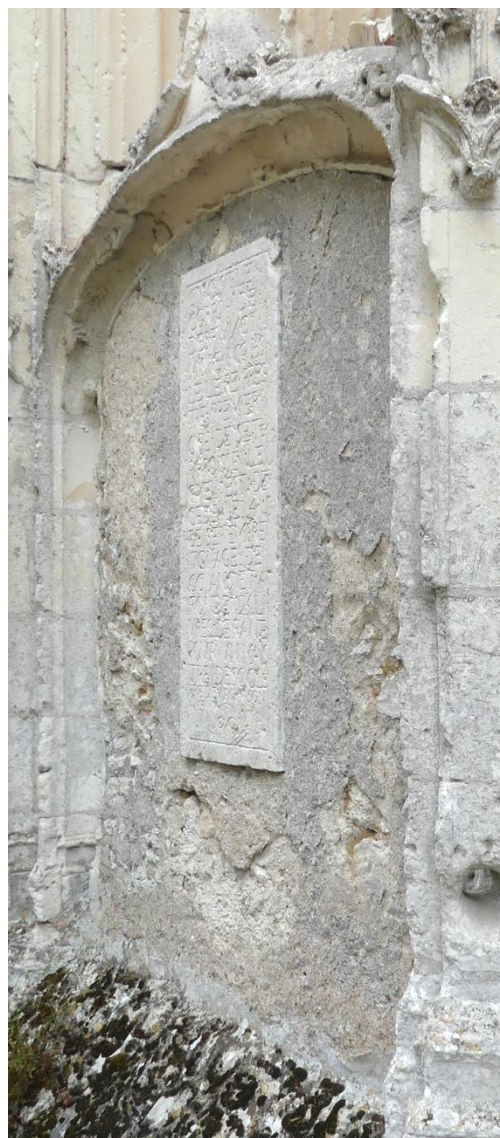
Façade nord, déplaquage d'enduit dégradant la présentation générale de l'ancien portail
