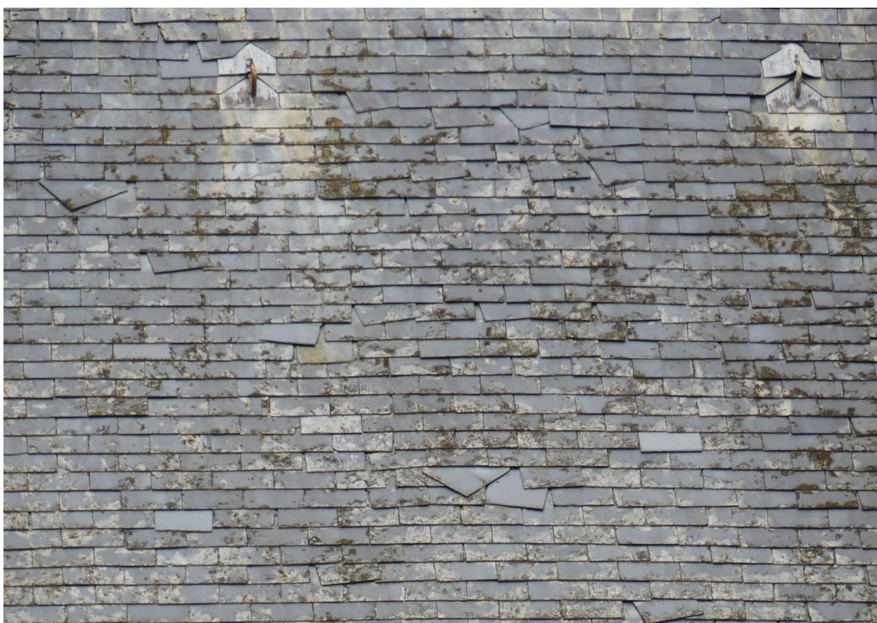
Versant sud de la nef, désorganisation générale, nombreux glissements d'ardoises
