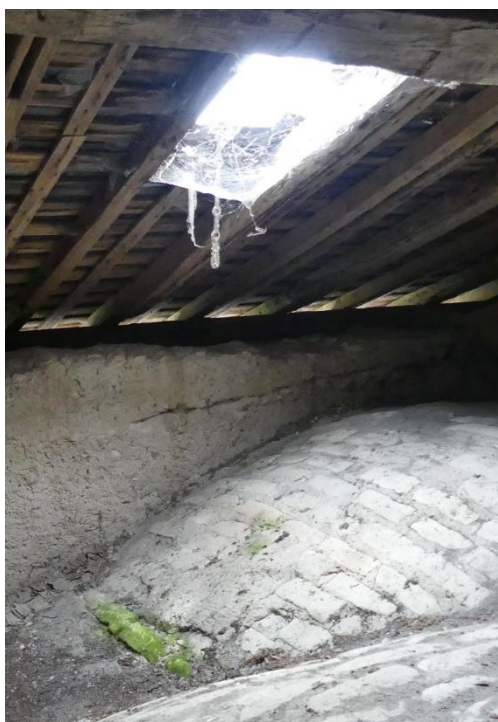
Bas-côté sud, développement d'algues vertes sur l'extrados de la voûte témoignant d'infiltration au droit du châssis
