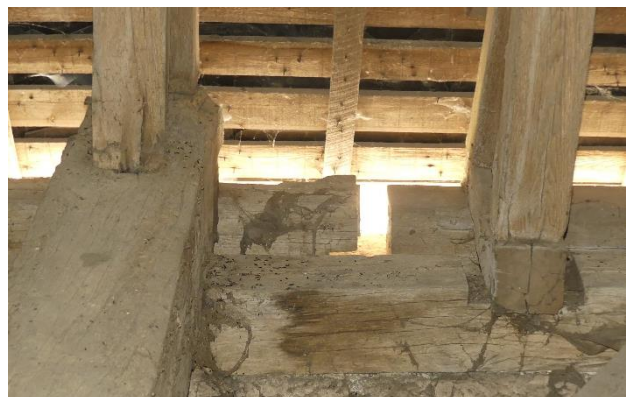
Chœur, non-continuité de la panne sablière extérieure
