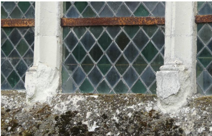
Façade nord, baie 3, desquamation et forte pulvéulence des pieds de meneaux et de l'encadrement en pierre de taille
