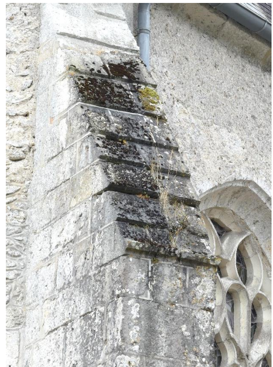
Façade est, importante pollution microbologique sur le glacis de contrefort
