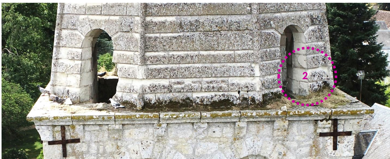
Face est de la flèche, premières assises de pierre dégradées, corniche déjointoyée, stationnement de volatiles
