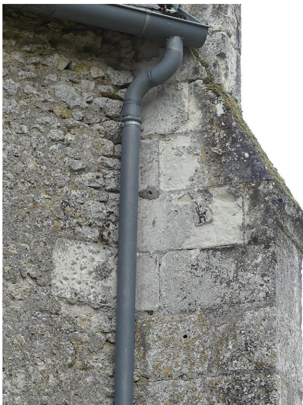
Angle nord-est de la chapelle nord, maçonnerie déjointoyée sous le raccord entre la gouttière et la DEP
