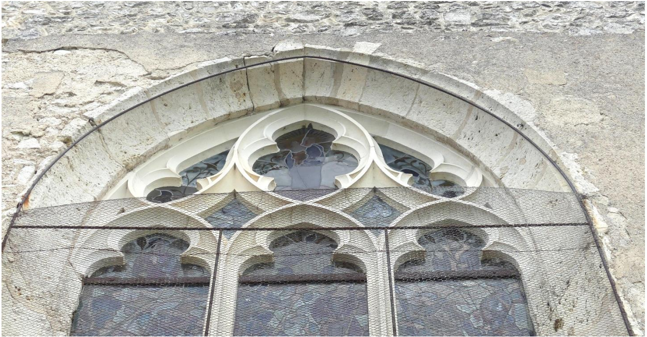
Façade sud, baie 6, maille de la protection grillagée décrochée du cadre ne protégeant plus le vitrail
