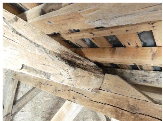
Bas-côté sud, panne altérée par d'anciennes infiltrations (chevron se trouvant au-dessus remplacé)
