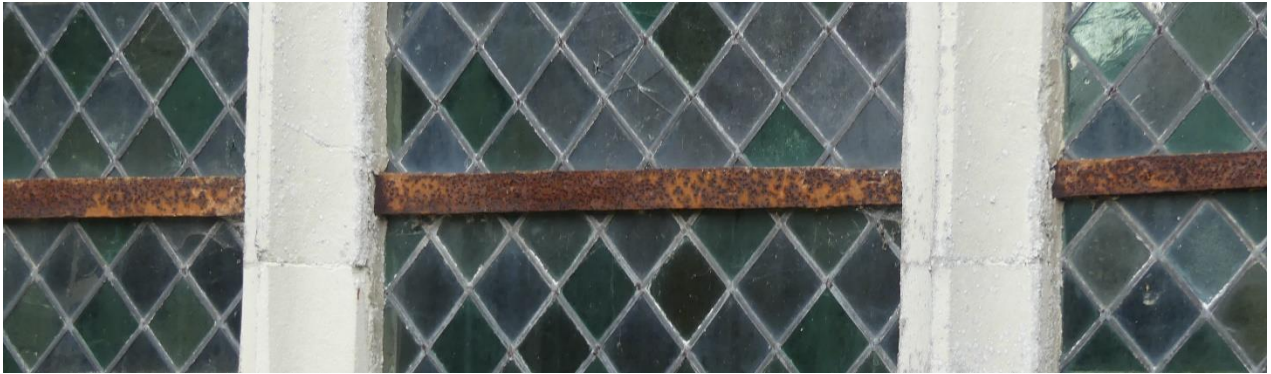
Baie 3 (façade sud), corrosion de surface des barlotières et calfeutrements lacunaires
