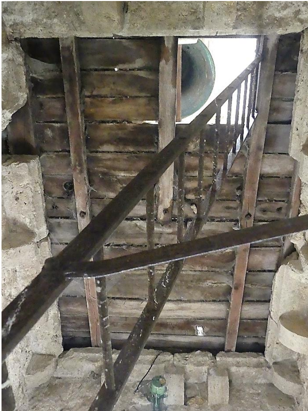
Plancher du beffroi, solivage partiel entraînant un défaut de maintien des planches (accès non sécurisé)
