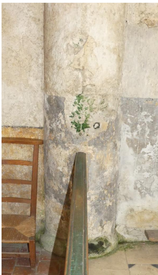
Mur nord de la nef, développement d'algues vertes sur la colonne engagée indiquant la présence d'humidité dans le mur
