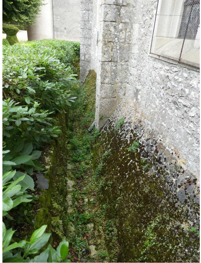
Façade nord, soubassement au mortier hydraulique pollué par les mousses
