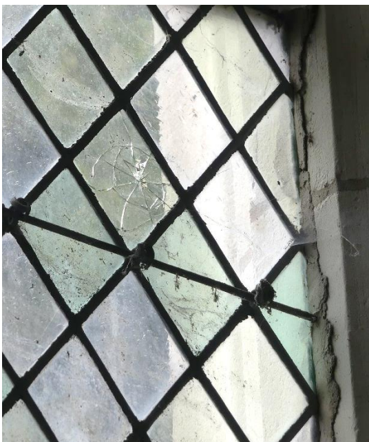
Baie 3 (nord), verres fracturés et calfeutrement au mortier à base de liant très hydraulique
