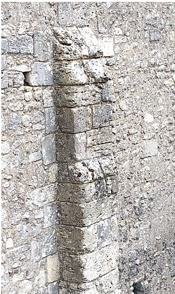
Façade ouest, partie haute du contrefort déjointoyée
