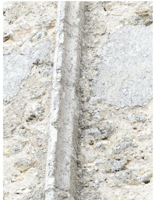
Façade est, baie 0, meneau légèrement desquamée
