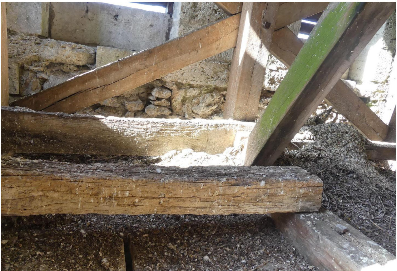
Beffroi, les pièces de bois exposées aux intempéries sont davantage dégradées ainsi que les éléments posés au sol qui sont en contact avec les déjections de volatiles et l'humidité
