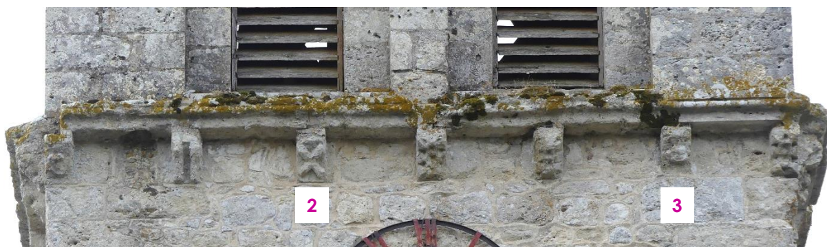
Face nord du fût du clocher, modillons sculptés de la corniche et du bandeau pollués par les lichens : 1/ modillon issu d'une restauration 2 et 3/ modillons plus anciens desquamés
