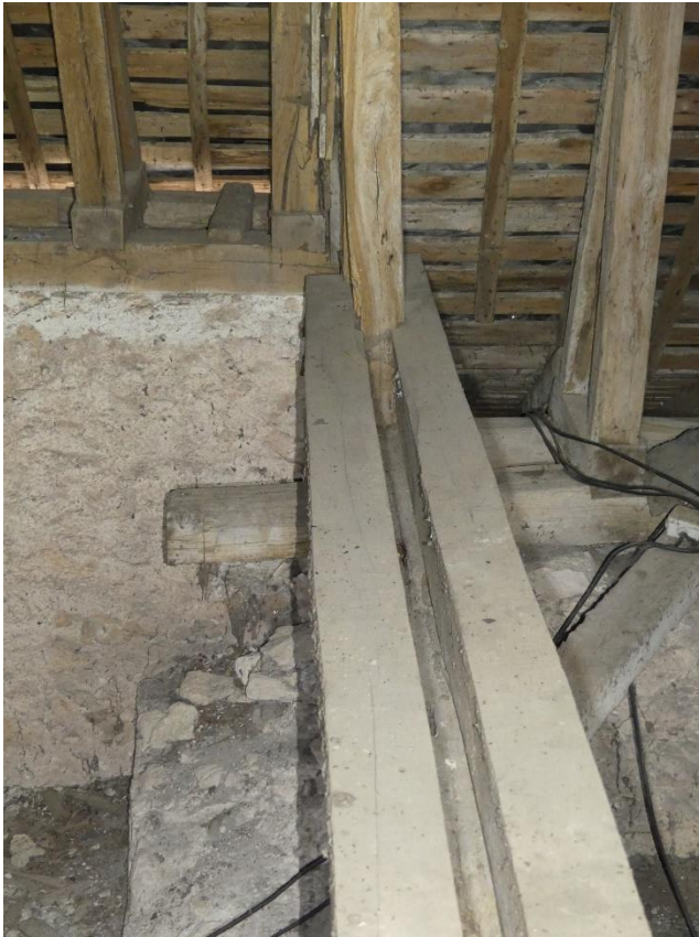
F5 (jonction entre la nef et le chœur), entrait renforcé par moisage
