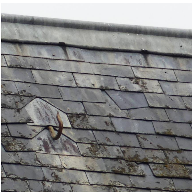
Versant sud de la nef, lacune d'ardoise. Faîtage zinc et bande de réparation en plomb.
