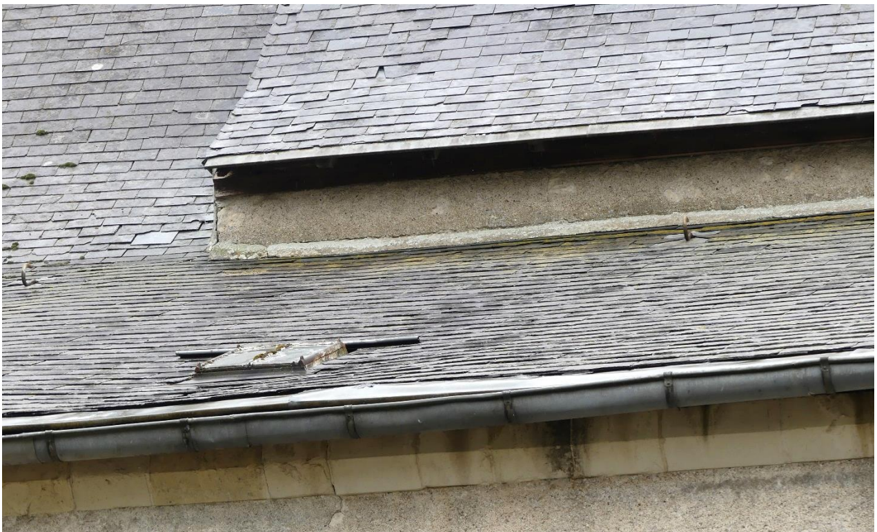
Couverture du bas-côté nord déformée indiquant un affaiblissement du support, défaut d'étanchéité en bas de pente entraînant une altération de la corniche en pierre sous-jacente. Glissements et désorganisation de la couverture de la nef en partie basse
