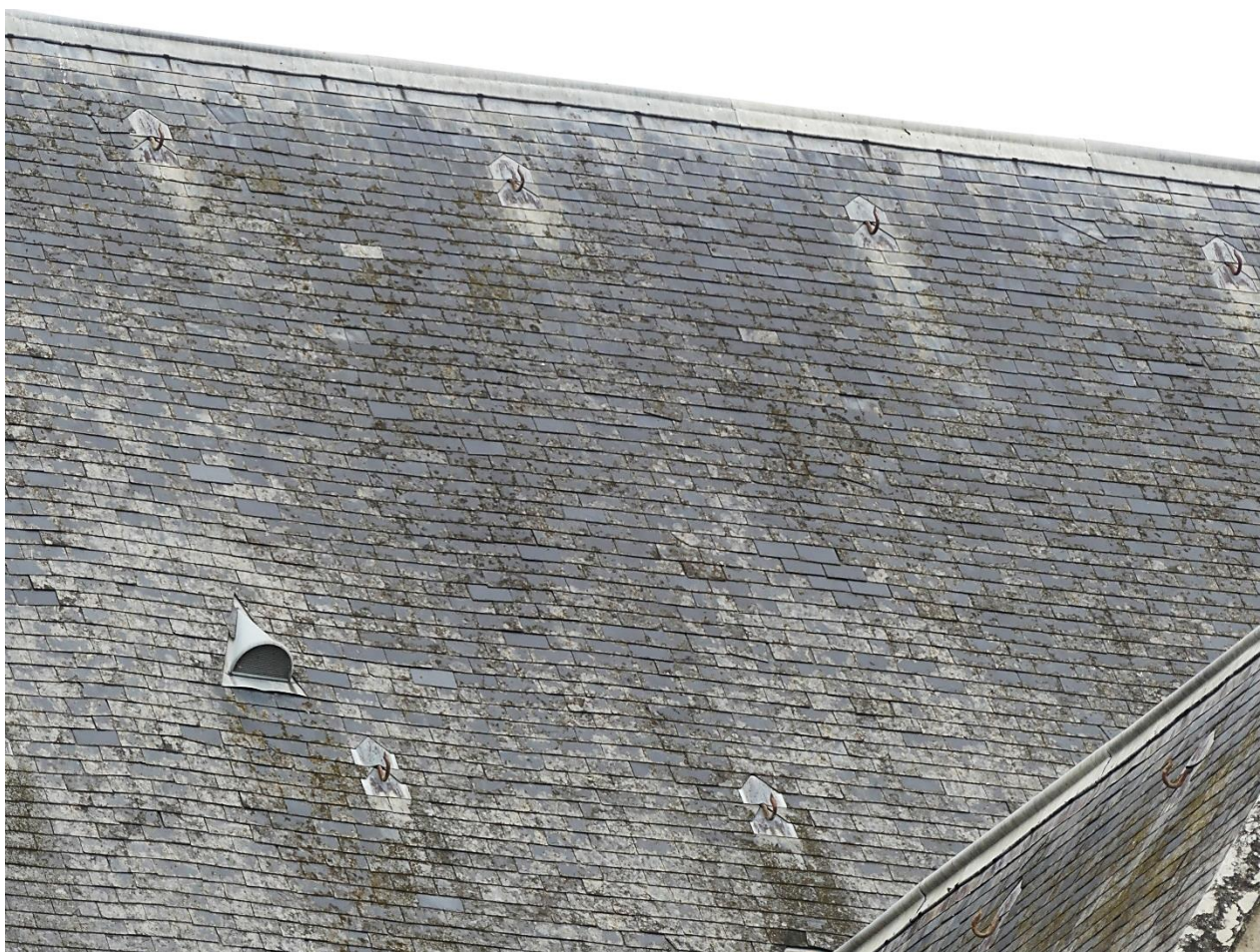
Versant sud de la nef, nombreux glissements d'ardoise et repiquages
