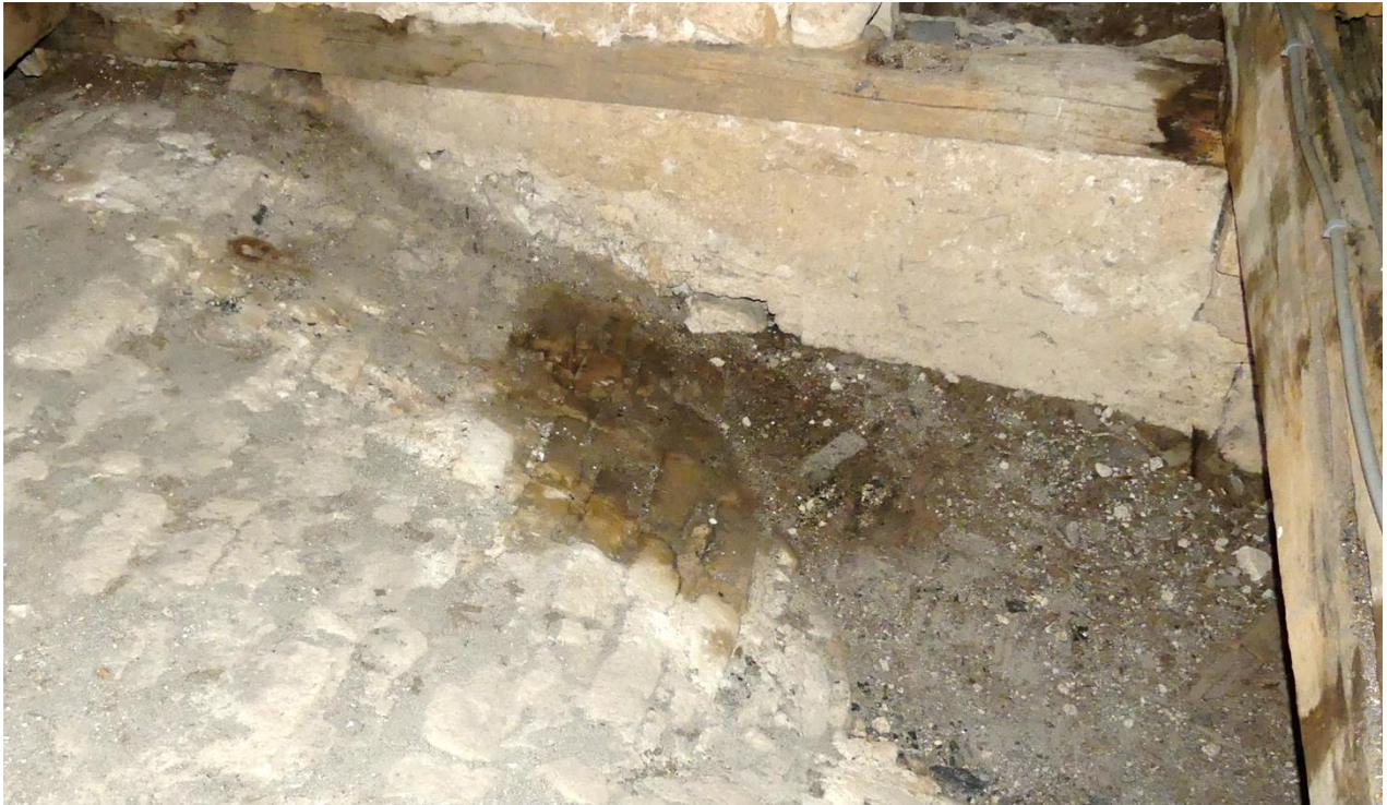
Chapelle Sainte-Radegonde (sud), traces d'une infiltration sur l'extrados de la voûte provenant d'une noue fuyarde
