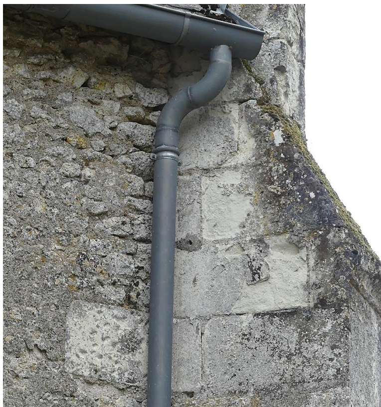
Angle nord-ouest de la chapelle nord, parements lessivés par les eaux de pluie provenant de la gouttière (tête de contrefort desquamée et maçonnerie de moellon déjointoyée)
