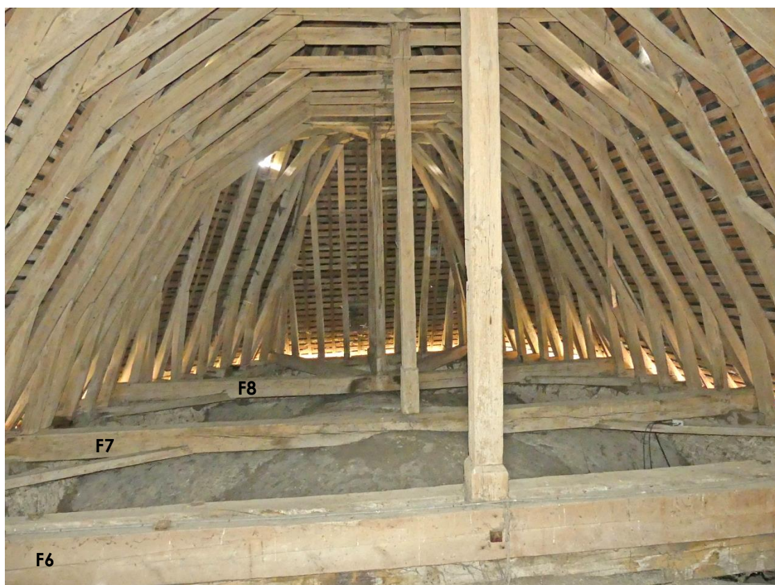
Vue générale de la charpente du chœur (vers l'est) F6 : ferme renforcée par moilage de son entrain / F7 : ferme entaillée pour permettre le passage de la voute du chœur / F8 : importante infiltration au niveau du poinçon
