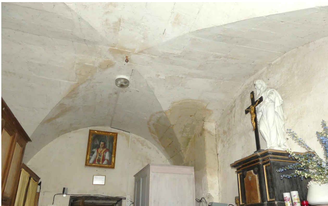
Sacristie, traces d'infiltration sur l'intrados de la voûte provenant d'un chéneau encaissé défailant
