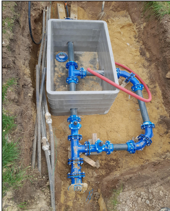
Cour sur Loire - rue Nationale de Fleury - équipement interconnexion
