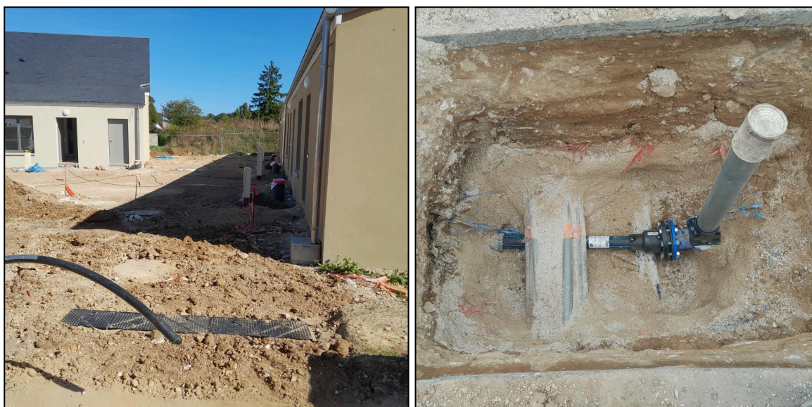
Ménars - Zac des Coutures - branchement avec 10 compteurs pour bâtiment collectif
